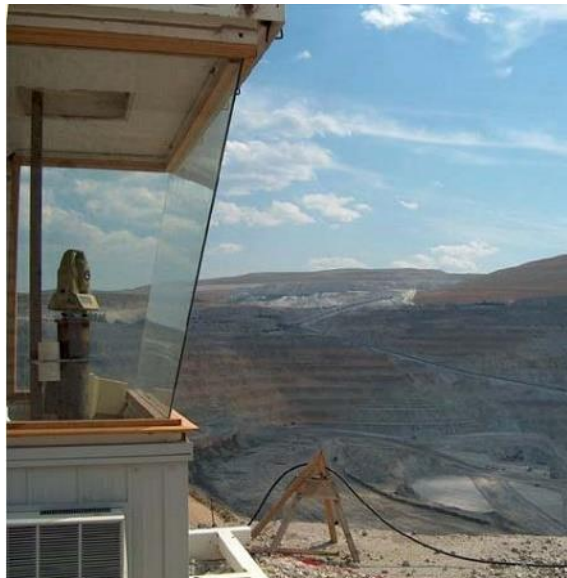
Рисунок 3.7 – Станция автоматизированного призменного мониторинга
